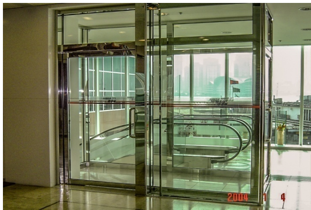
商場防火區域出路防火玻璃門連間隔
