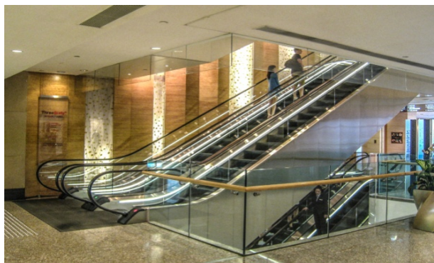
扶手电梯防火玻璃擋煙屏障(Smoke Barrier)
